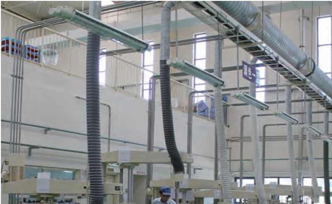
作业现场抽风设施
