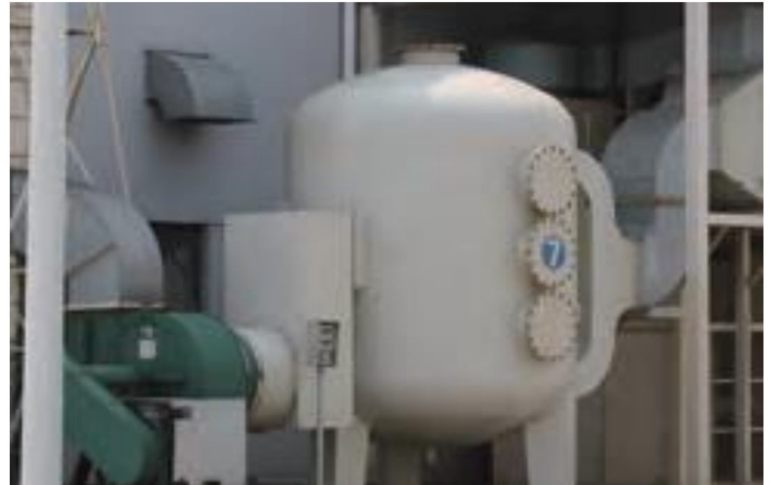
废气治理设施
